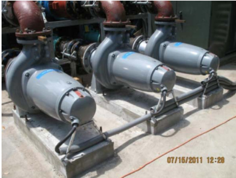
Photo 3 – Existing Flygt Pumps
